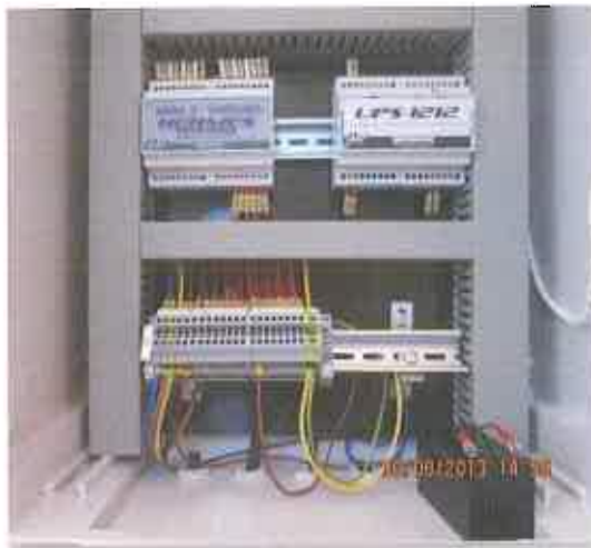
Ejemplo Fotografía interior cuadro con TCR200
